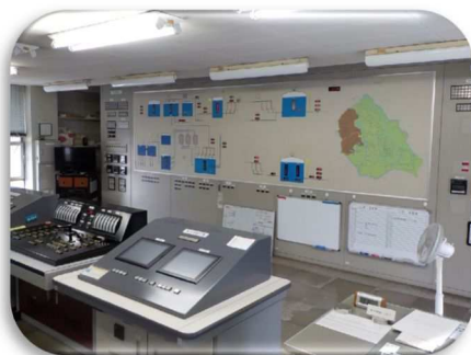
中央監視・制御設備
