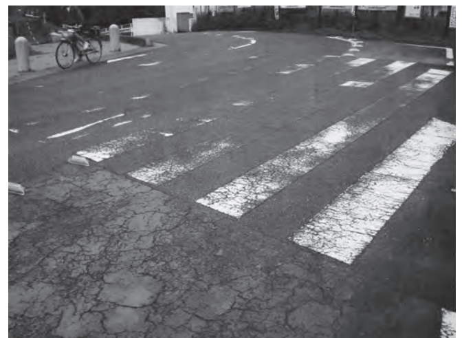
薄くなっている横断歩道
