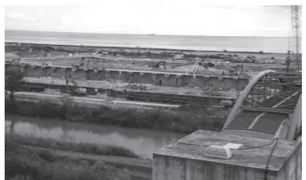
被災した処理施設
