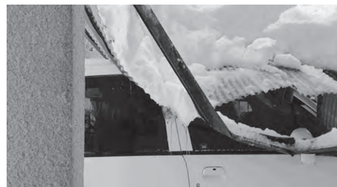
積雪被害にあったカーポート
