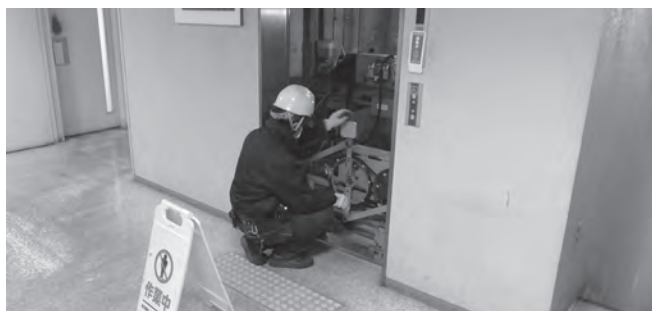
点検中のエレベーター
