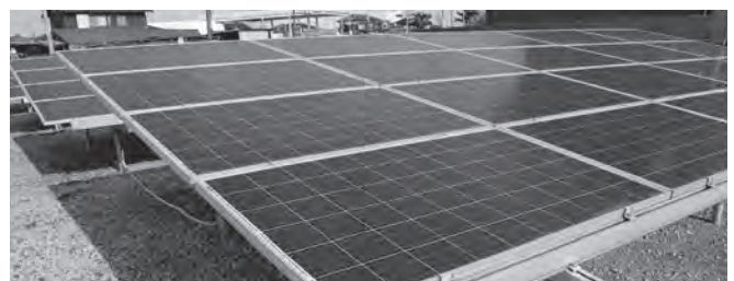
太陽光パネル
