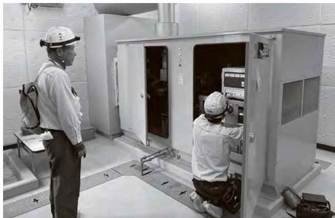
かばかりや 蚊斗谷配水場および非常用自家発電機(点検中)
