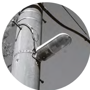
道路照明灯 ナトリウム灯
