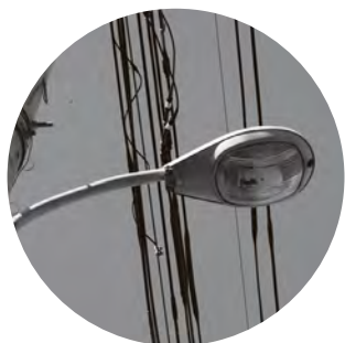
道路照明灯 水銀灯
