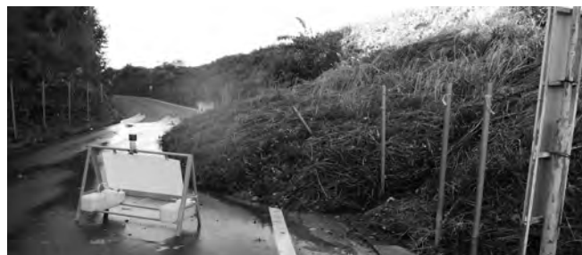
台風19号の影響で小学校の通学路際でがけずれ発生
