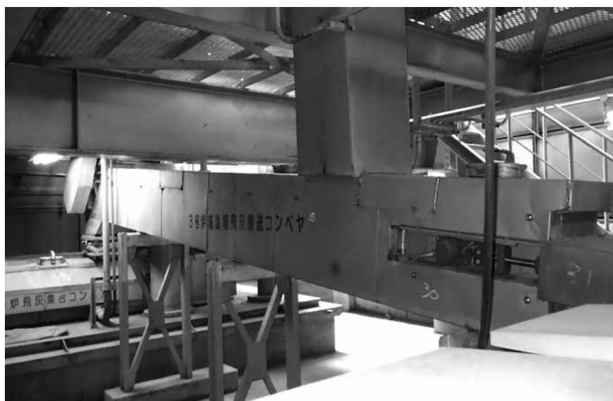
減温塔飛灰搬送コンベヤ
