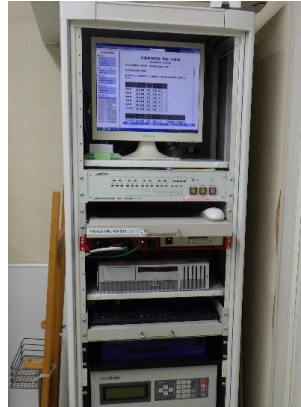
防災無線室 入口右側
