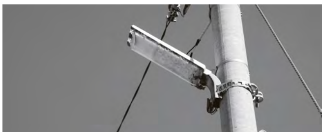
道路照明灯 LED灯
