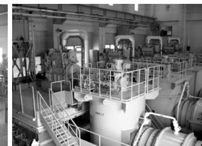
▲排水ポンプ直径1.5m x 4基
