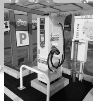
▲電気自動車急速充電器
