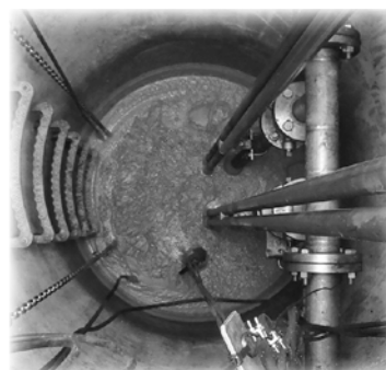
▲マンホール内に貯まり、固まった油
