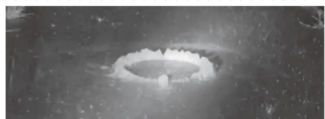
マンホールからあふれ出している状況▶
