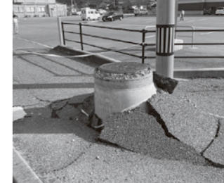
写真④ マンホール浮上箇所が多数
