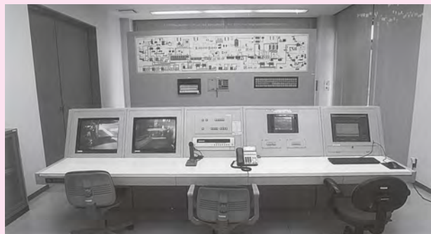
中央監視室 汚泥を処理し、川に放流するまでの工程監視装置
