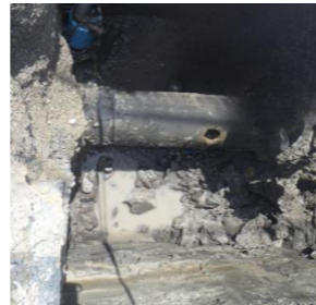
老朽化により水道管が破損した様子 (令和2年8月 万光寺地内)
